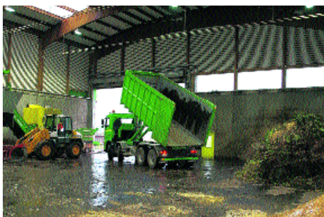
Energie aus organischem Abfall: Durch die Vergärung von Biomasse entsteht in Pratteln in der Biopower Nordwestschweiz AG Biogas.
